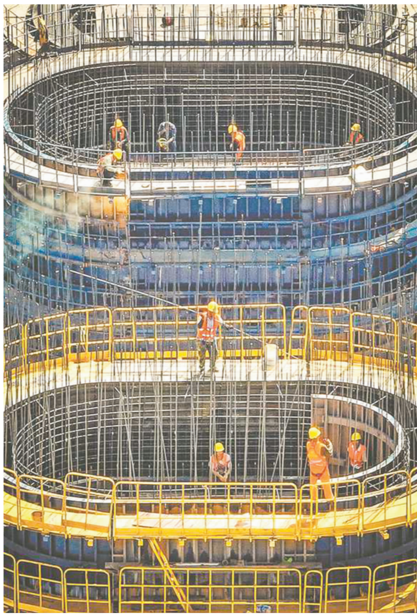
成渝中线高铁千秋墩双线特大桥施工现场,工作人员加紧作业。图视视觉重庆
