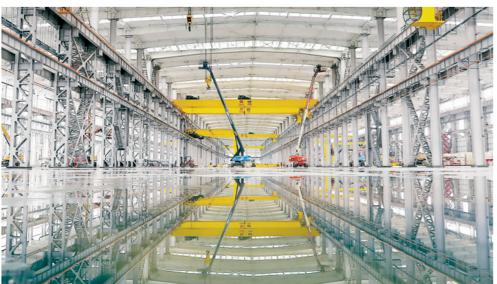
四川交投钢构制造产业基地项目厂房内正在抢抓工期建设。 眉山日报全媒体记者 雷同 摄
