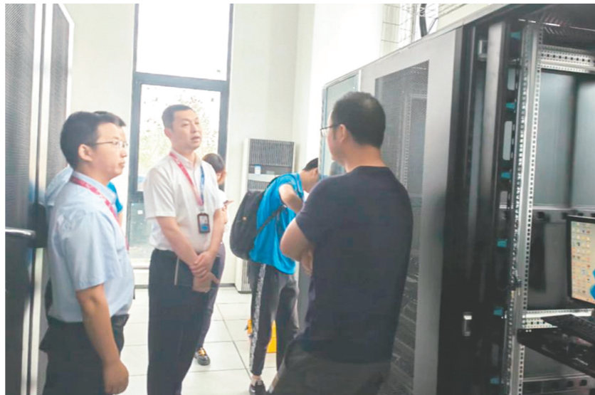
专家团队走进企业机房开展网络巡检及诊断服务。
