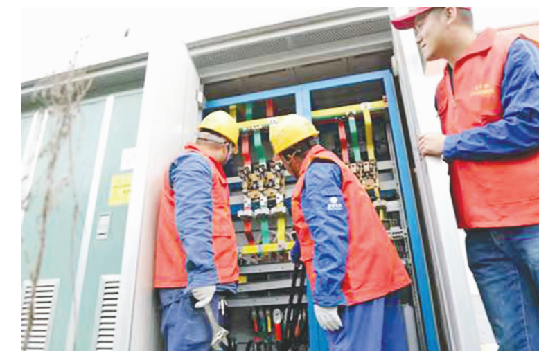
做好电力保障。
