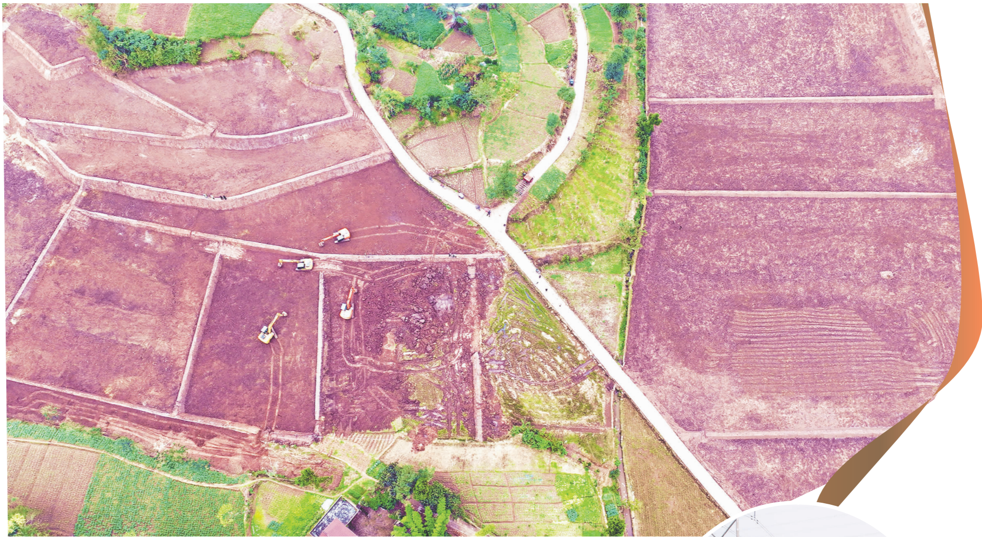
仁寿县彭加镇钵炉社区的高标准农田建设项目施工现场。 潘帅 摄
