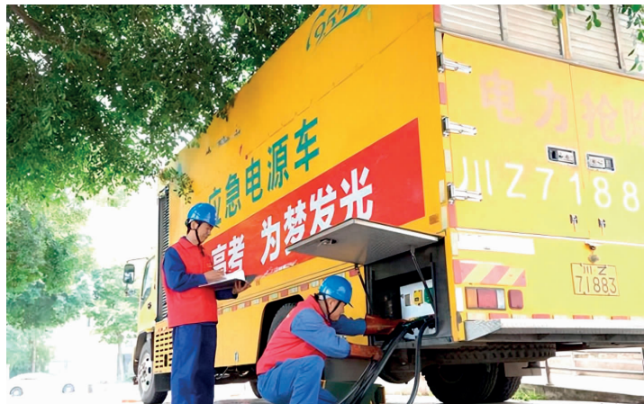
连心桥共产党员服务队队员在仁寿一中北校区高考考点检查应急电源车。
