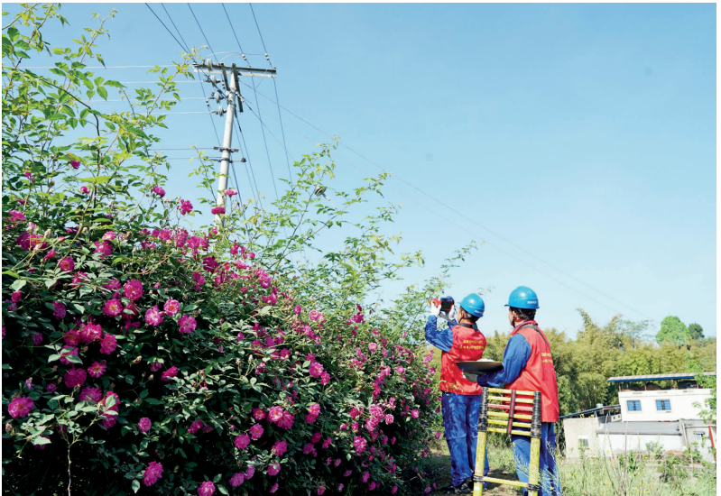
电力工人手持红外测温仪巡视电力设备。
