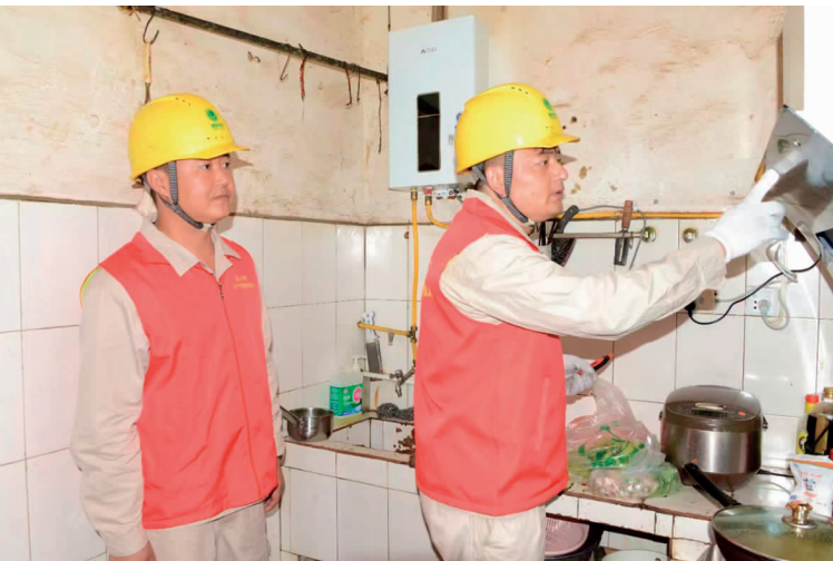
排查家用电器设备安全隐患。
