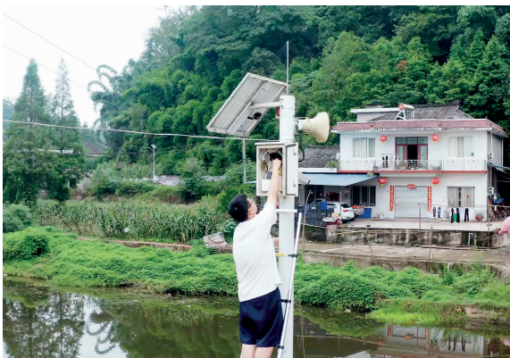
工作人员对防汛监测预警设备进行“健康体检”。
