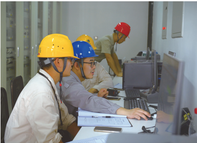
变电运维人员在变电站主控室监盘。吴华羽 摄
