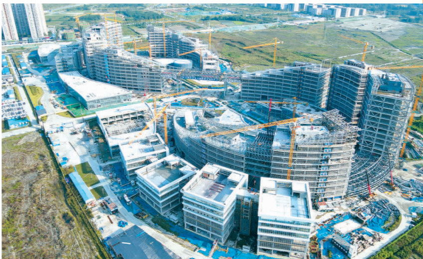
成都重点产业项目建设火热,图为成都国盾融合创新中心项目建设现场。(图据《成都日报》)
