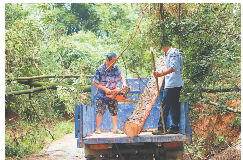
8月22日,因为连续的下雨刮风,东坡区崇仁镇张场村的一条村路旁的树木出现断裂,阻挡了过往的行人和车辆。该村立即安排工作人员前往施工,及时恢复道路通畅。 本报记者 胡秉曦 摄
