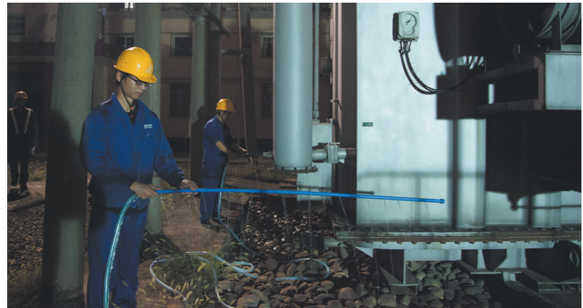
电力工人采取水淋为变压器降温。 邓宫泰 摄
