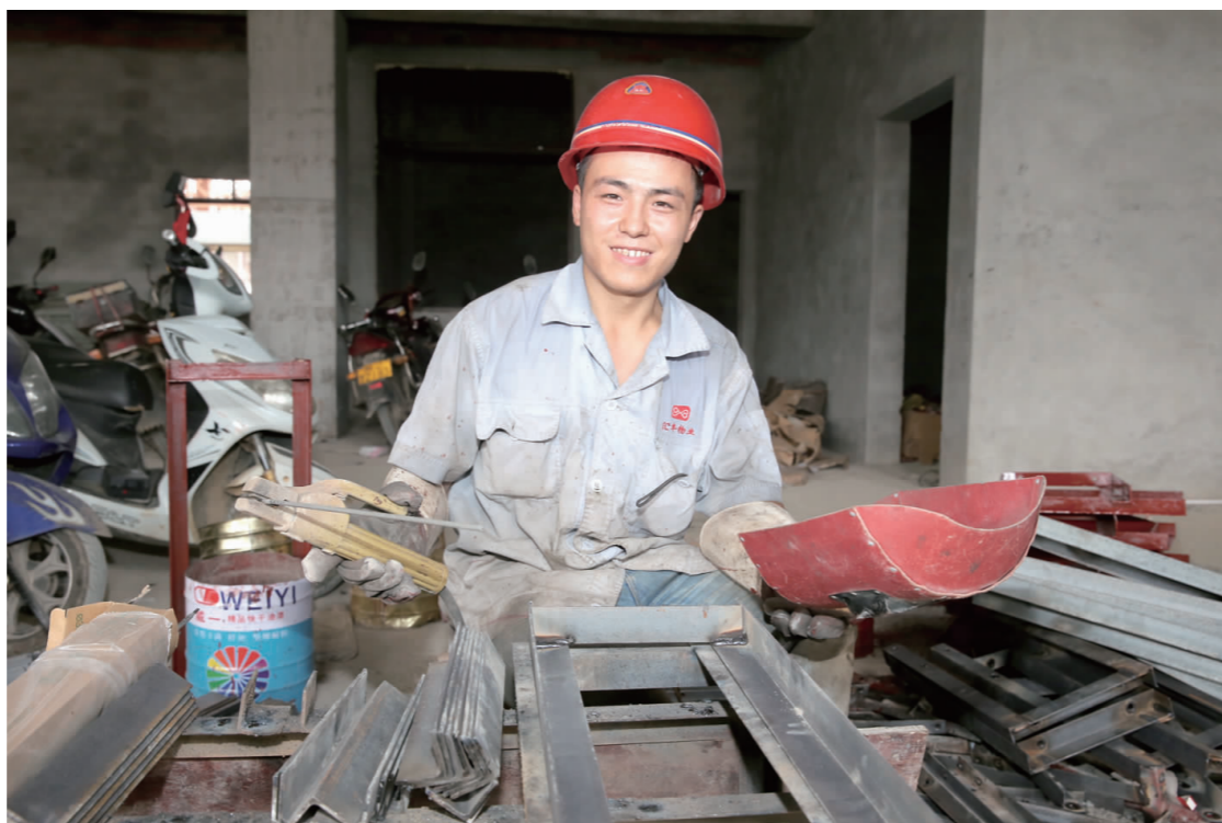
市中医院养护中心项目建设现场,工人在高温环境下施工。
