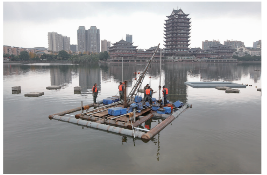
12月12日,在东坡城市湿地公园的东坡湖,水幕电影工程正在施工。为进一步满足群众业余文化生活的需求,我市在去年底建成使用西南地区首座“水舞剧场”——东坡湖水舞音乐喷泉的基础上,近期又新建水幕电影、水膜表演、彩色激光表演等项目...
